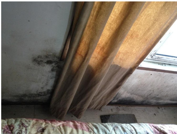
Photo : Moisissures dans une chambre partagée par plusieurs enfants (Première Nation de Sandy Lake, Ontario).
