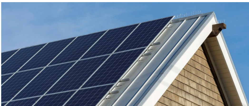
L'utilisation de l'énergie solaire est l'une des différentes options de remplacement de combustible dans le secteur du bâtiment.
